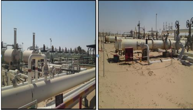
شكل (4). منطقة تجمع خطوط النفط الخام في المجمع الرئيسي بالحقل.
